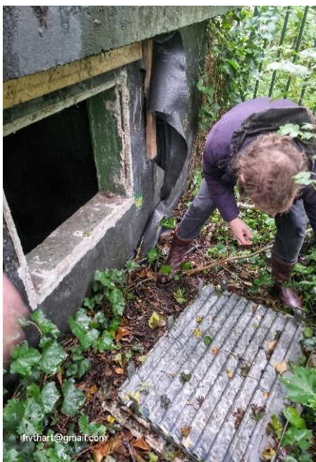
Figuur 6 Detail van de bovenkant van de Reinwaterkelders met de ontluchting.
